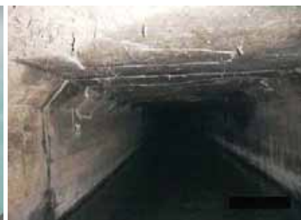
硫酸ガスで劣化した水路
