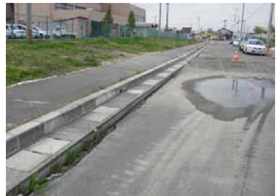
車道は液状化と沈下が若干認められる
