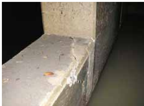
突合せ部ひび割れ
