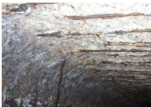
写真－7 劣化部拡大
