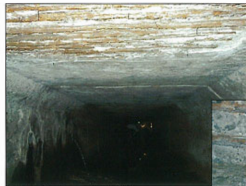
【むき出しになった鉄筋】
