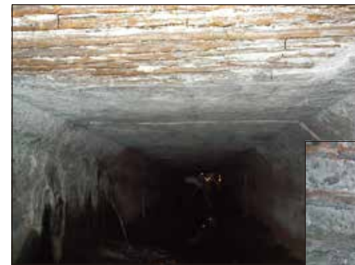
【むき出しになった鉄筋】
